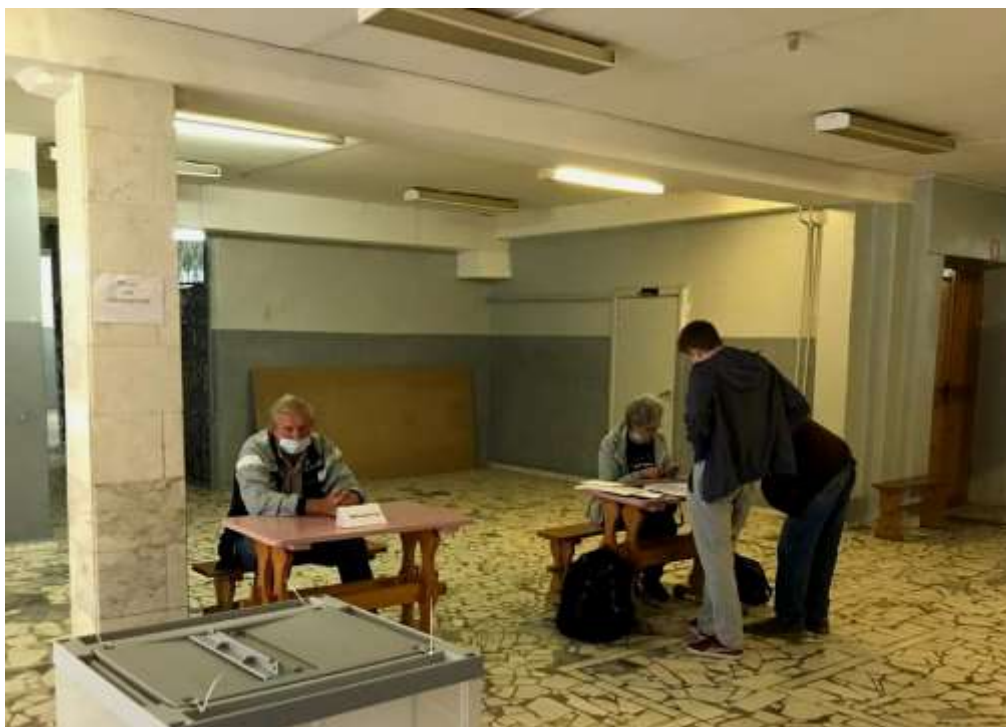
Помещение для голосования УИК № 179, видны неработающие лампы дневного освещения
